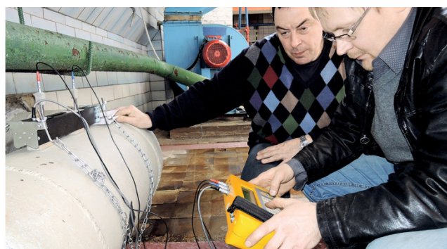
❖ Фото 5. Измерение расхода сточных вод в грабельном отделении
