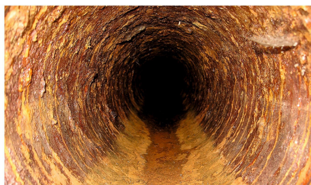
❖ Фото 7. Отложения на поверхности теплообменника-утилизатора
