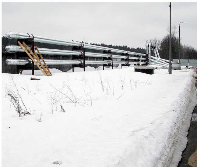
❖ Фото 2. Теплообменник-утилизатор на площадке возле здания ГКНС
