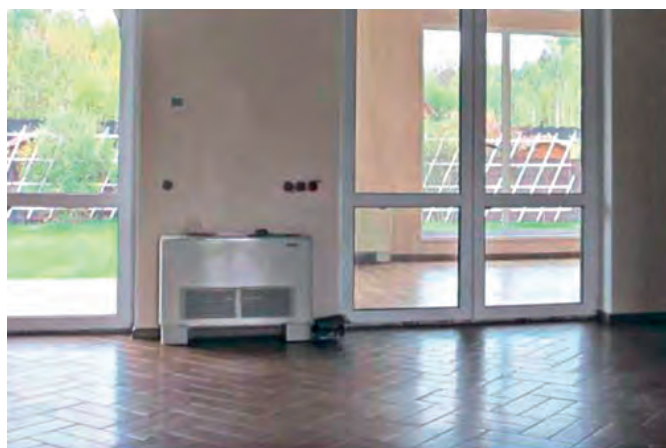
Фанкойл в кухне-столовой. Двери справа — вход в гостиную, за стеклом немного виден ещё один установленный в ней фанкойл
