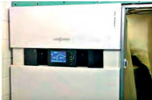
Подлестничная ниша перегорожена корпусом теплового насоса и дверкой рядом с ним
