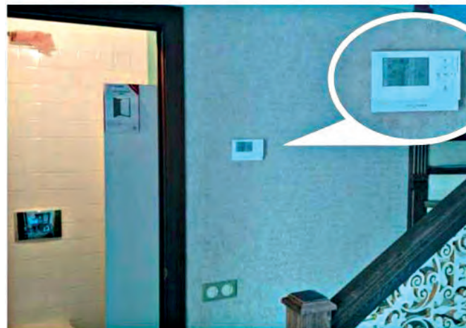
Терморегулятор Viessmann Vitotrol 200A, закреплённый рядом с «насосной»
