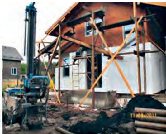
С помощью компактного бурового оборудования можно пробурить скважину для зонда или ХВС, не опасаясь сильно испортить окружающий ландшафт. Тут, впрочем, это неважно — скважины бурятся одновременно с обшивкой дома теплоизоляцией
