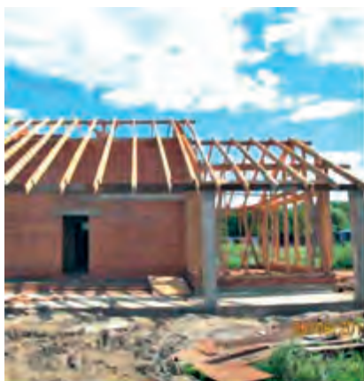
Начало строительства. Дом кирпичный, каркасная пристройка к нему — гостиная, свес крыши прикрывает будущую площадку для автомобилей, он поддерживается колоннами, установленными на монолитной плите
