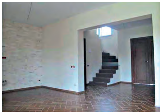
Отопительное оборудование установлено в нише под лестницей, ведущей на второй этаж
