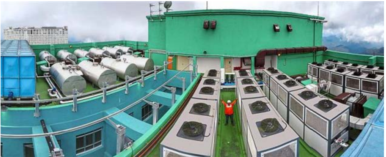
Гигантский «холодильник наоборот» обеспечивает горячий душ для гостей в отеле First World Hotel башня 3. Фото: The Star / Genting Bhd
