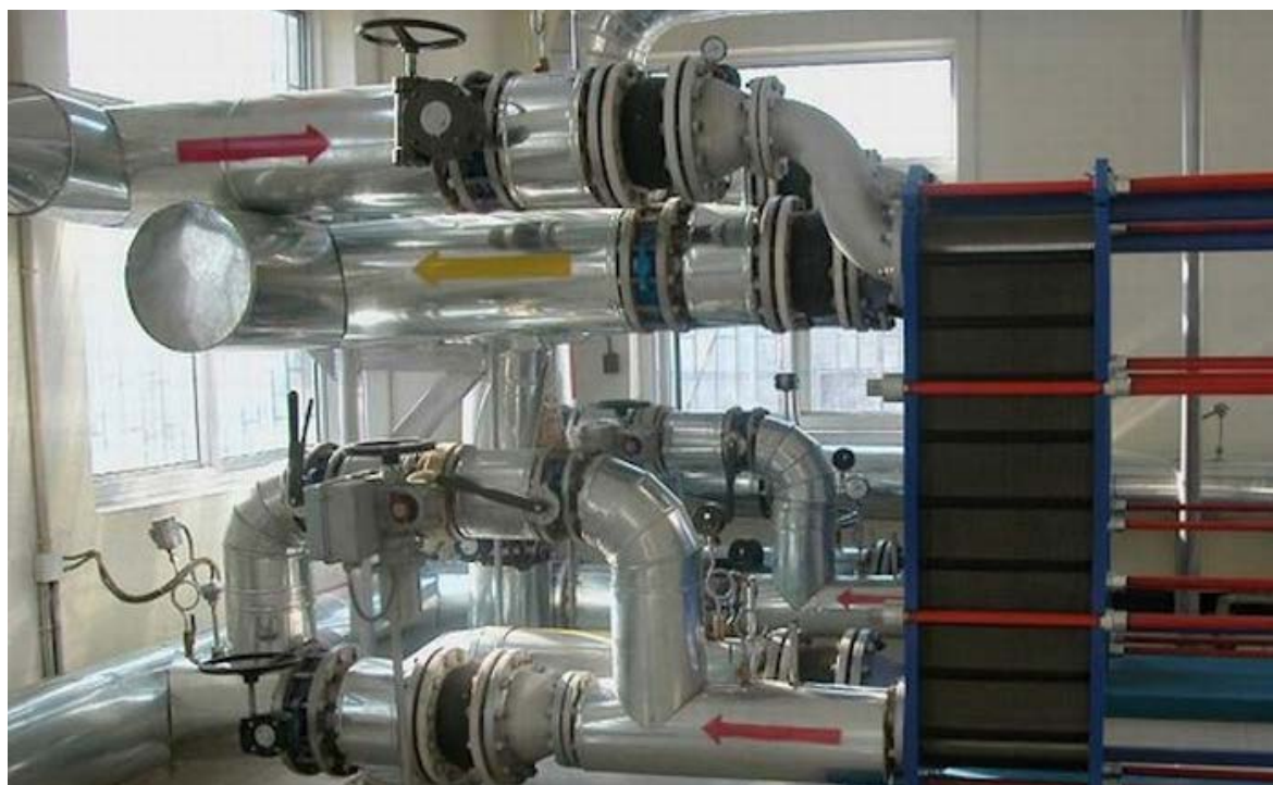
Геотермальная установка, Сиань Ян, провинция Шэньси, Китай
