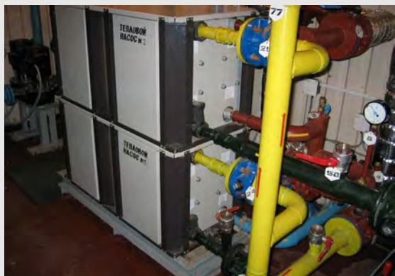
Фото 2. Тепловые насосы «гликоль-вода» тепловой мощностью по 70 кВт, установленные в контейнере
