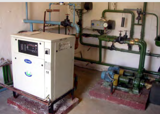
Фото 1. Тепловой насос «вода-вода» тепловой мощностью 45 кВт в топочной на твердом топливе
