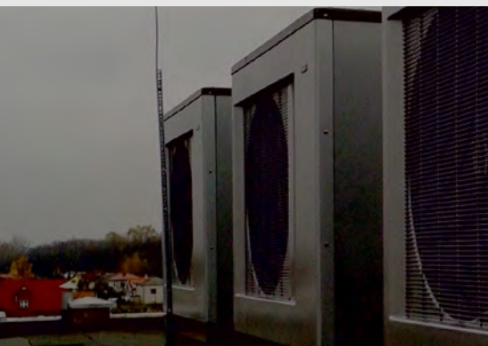
Фото 3. Испарительные блоки тепловых насосов «воздух-рассол» тепловой мощностью 60 кВт (3x20 кВт), установленные на крыше многоквартирного жилого дома
