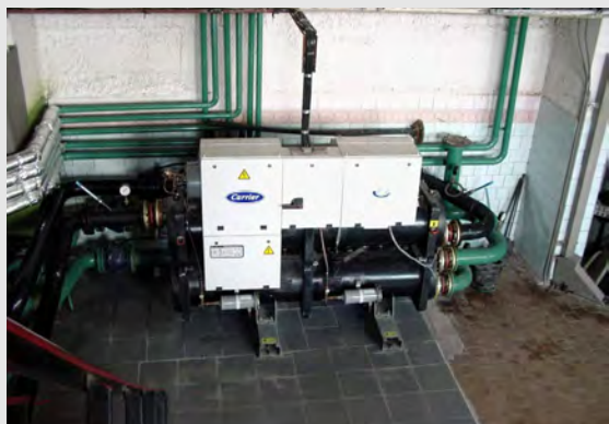
Фото 4. Тепловой насос «вода-вода» тепловой мощностью 200 кВт
