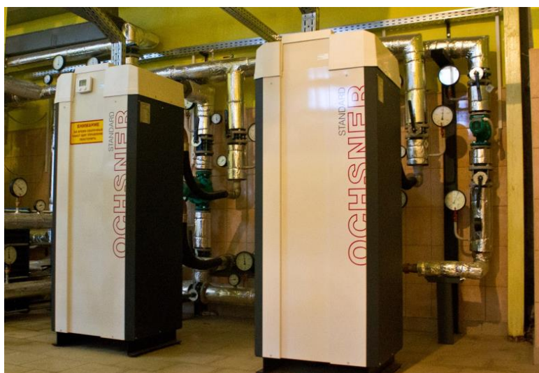
Илл.4.3 – Размещение и обвязка тепловых насосов TERRA61 фирмы «Ochsner» (Австрия)
