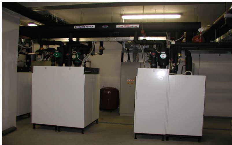
Илл.4.2 – Размещение и обвязка тепловых насосов Greenline F 65 фирмы «IVT» (Швеция)
