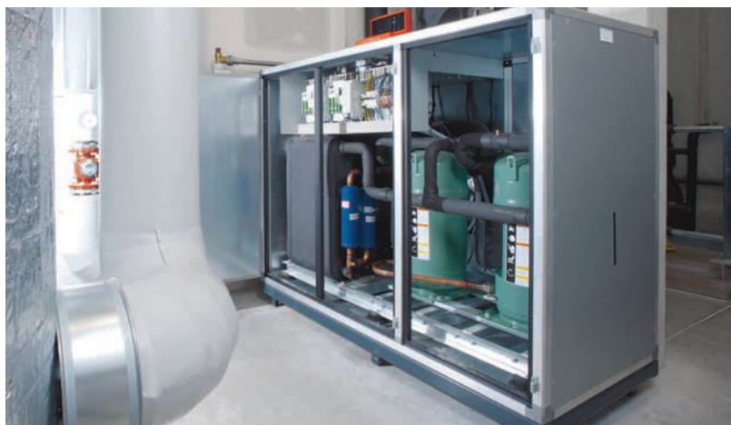
Рассольно-водяные тепловые насосы Vito-cal 300-G Pro каждый мощностью 150 кВт
