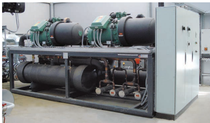
Водо-водяной тепловой насос мощностью 1560 кВт
