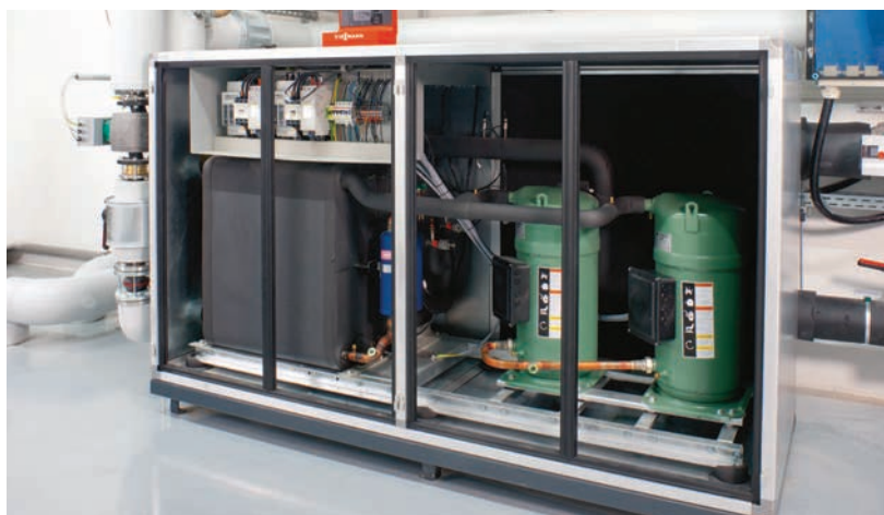
Рассольно-водяной тепловой насос 2 x Vitocal 300-G Pro, мощность 2 x 242 кВт
