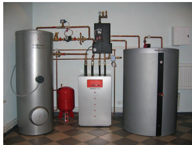
Геотермальный тепловой насос мощностью 14 кВт с бойлером и буферной емкостью
