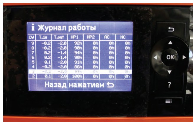
Середина отопительного сезона (CW - номер недели; T.in - температура теплоносителя грунтового контура на входе в тепловой насос; T.out - температура теплоносителя грунтового контура на выходе из теплового насоса; HP1 - количество часов наработки компрессора)
