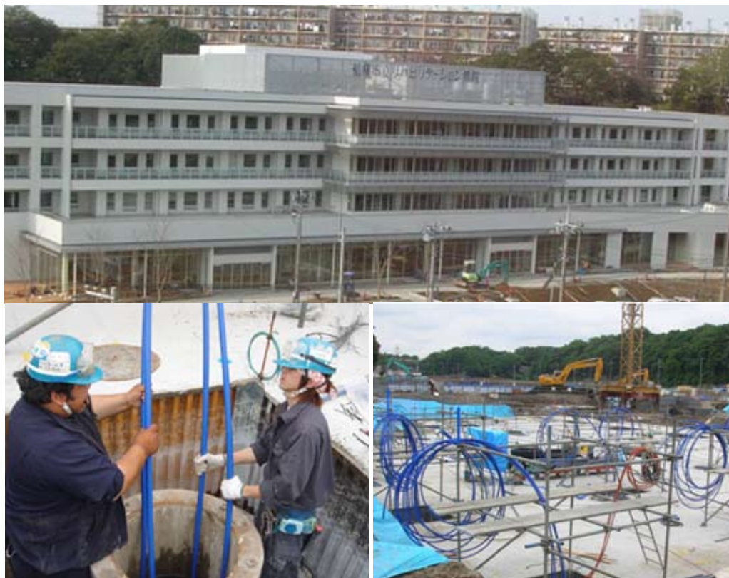
Фото 3. Закрытая система, использующая сборные сваи в фундаменте реабилитационной больницы города Funabashi. Вверху: Внешний вид больницы. Слева: вставка двух U-образных трубок в полость сборной сваи. Справа: Вывод U-образных трубок сборных свай над конструкцией
