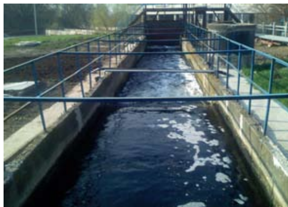
Рисунок 2. Открытая часть лотка сброса сточных вод
