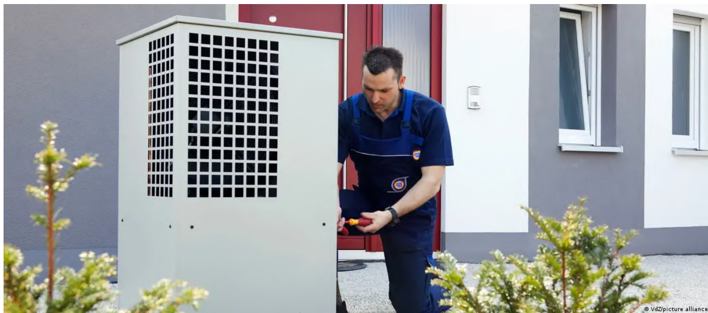
Установка теплового насоса перед многоквартирным домом в Германии
