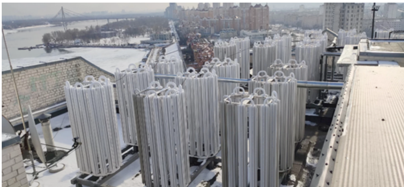
Тепловые насосы для системы отопления на крыше дома ОСМД «Арован». Фото: Facebook / Денис Кукса
